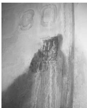
(パイプから水がもれている所)
